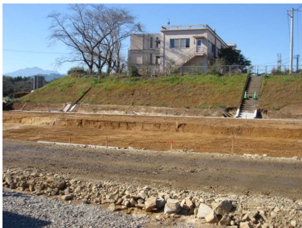
図 2.2 盛土による郊外の市道の建設。奥に見える住宅地も盛土によって造成されたものである。
